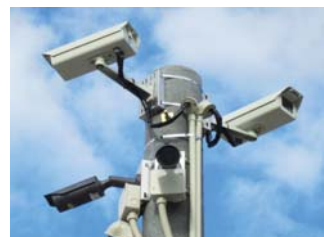
<遠隔監視システム>
