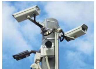
<遠隔監視システム>
